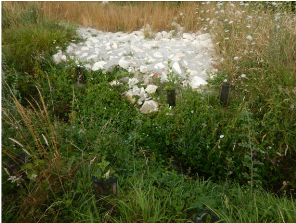
Figure 3 : Effondrement de la Noue
